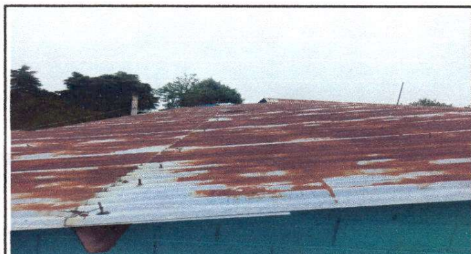
Foto 3: lamina en mal estado
