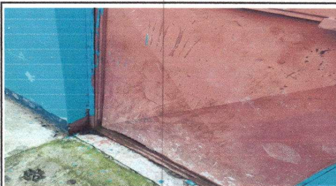
Foto 2: puertas en mal estado
