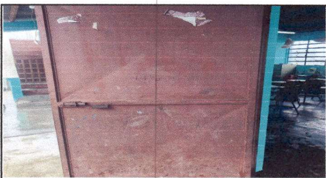
Foto 4: puertas sin chapa
