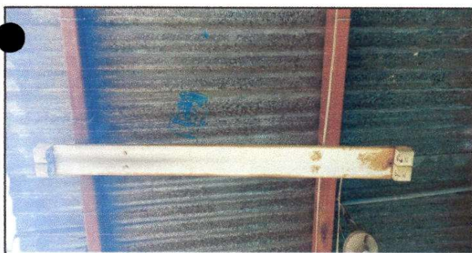
Foto 5: bases para lamparas en mal estado
