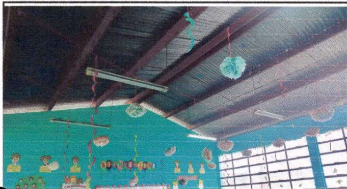
Foto 1: lamparas en mal estado
